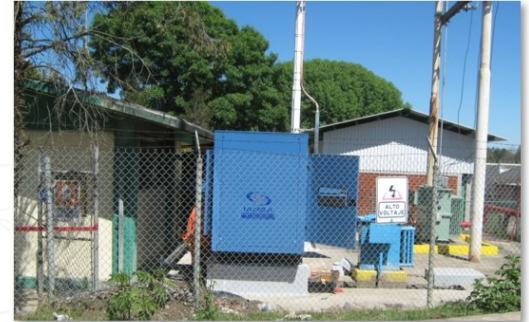
Estación Catalina PEMEX Puebla 300kVA
