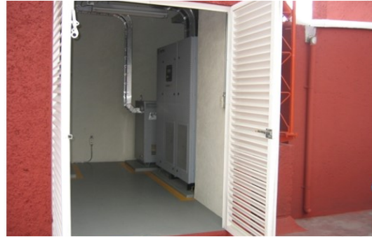
Condumex Corporativo 300 kVA
