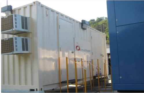
Estación Ceiba PEMEX Puebla 300kVA
